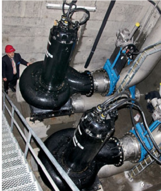
Figur 2-6 Kloakkpumpene ved Skøyen Vest varmesentral (Friotherm AG, 2008)
