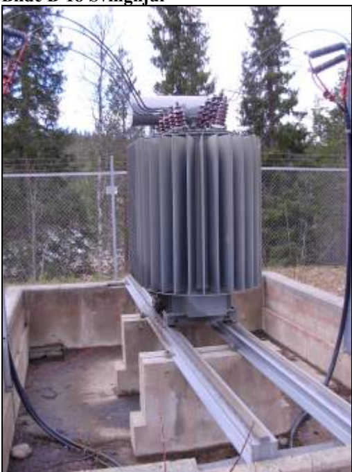
Bilde B-19 Transformator plassert utendørs
