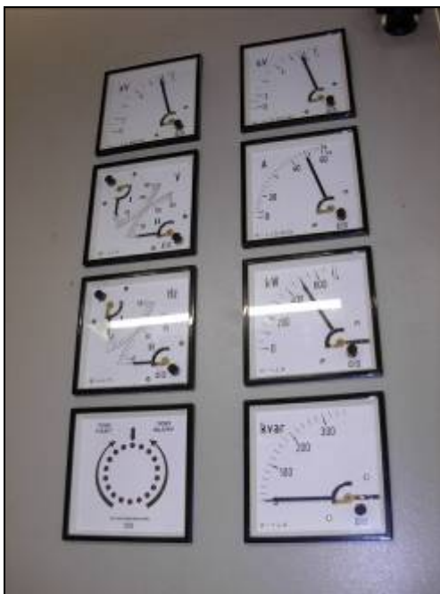
Bilde B-21 Kontrollanlegg
