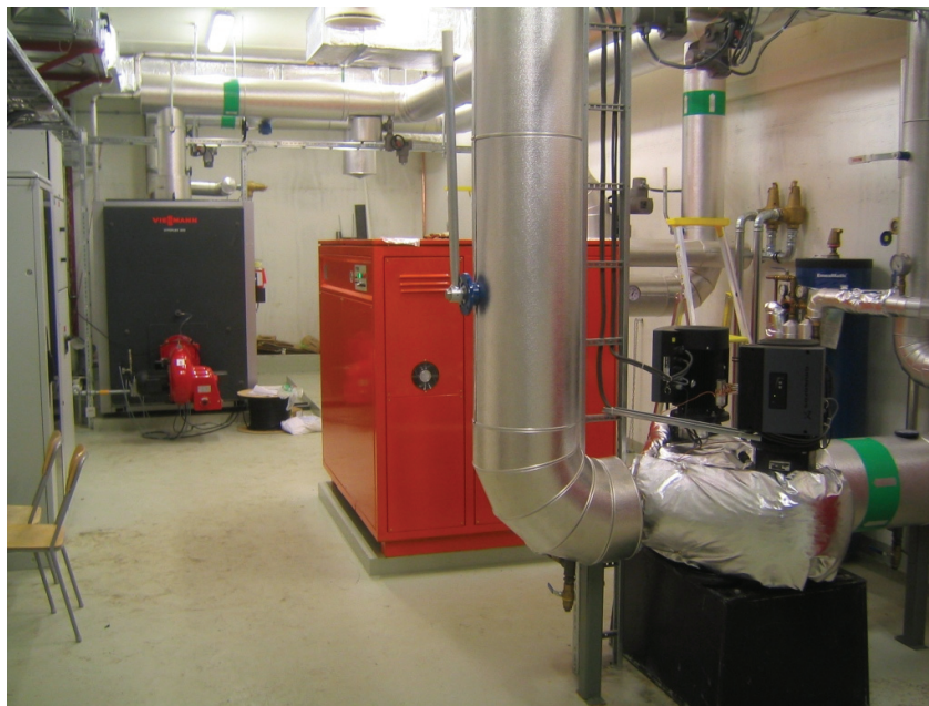
Figur 2.1-3: Varmesentralen på Tomasjord med gasskjel (bakerst), elkjel og pumper.
