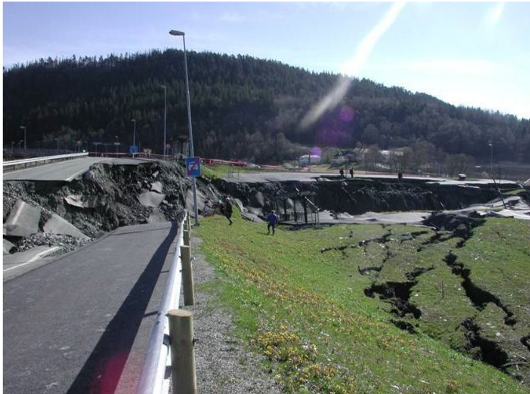
Figur B.2: Bilde av avkjøringsrampen ved Leistad etter skredet gikk.
