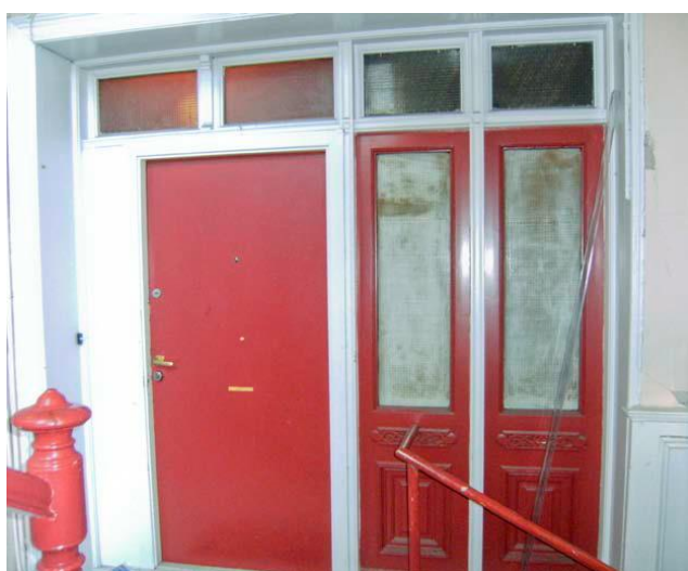
Figur 3 Ny branddør og gammel trefyllingsdør i trapperom(Korsaksel, 2009)
