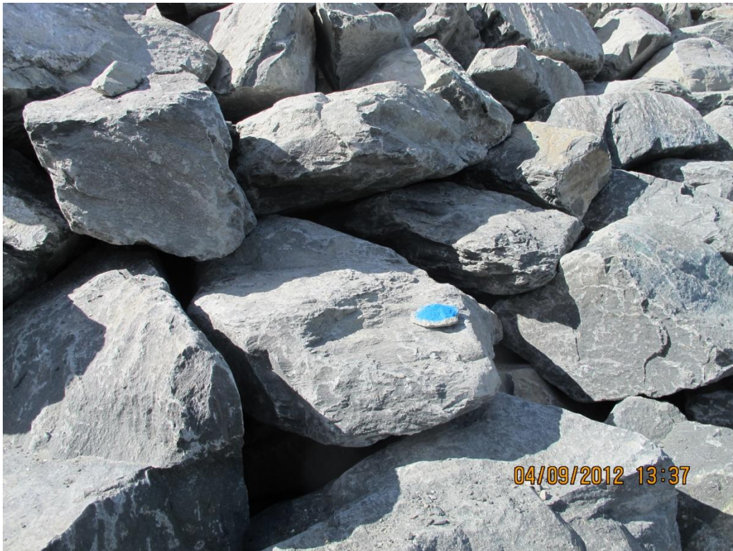
Figur 18: Detalj av plastring der kontrollør har markert at steinene ikke har god nok forband, og må derfor rettes opp av entreprenør (foto: Norconsult).
