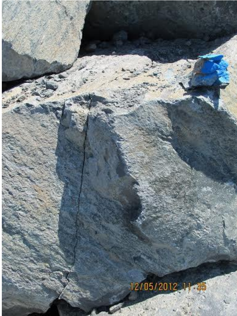
Figur 15: Vraket plastringsstein på grunn av oppsprekking (foto: Statkraft).
