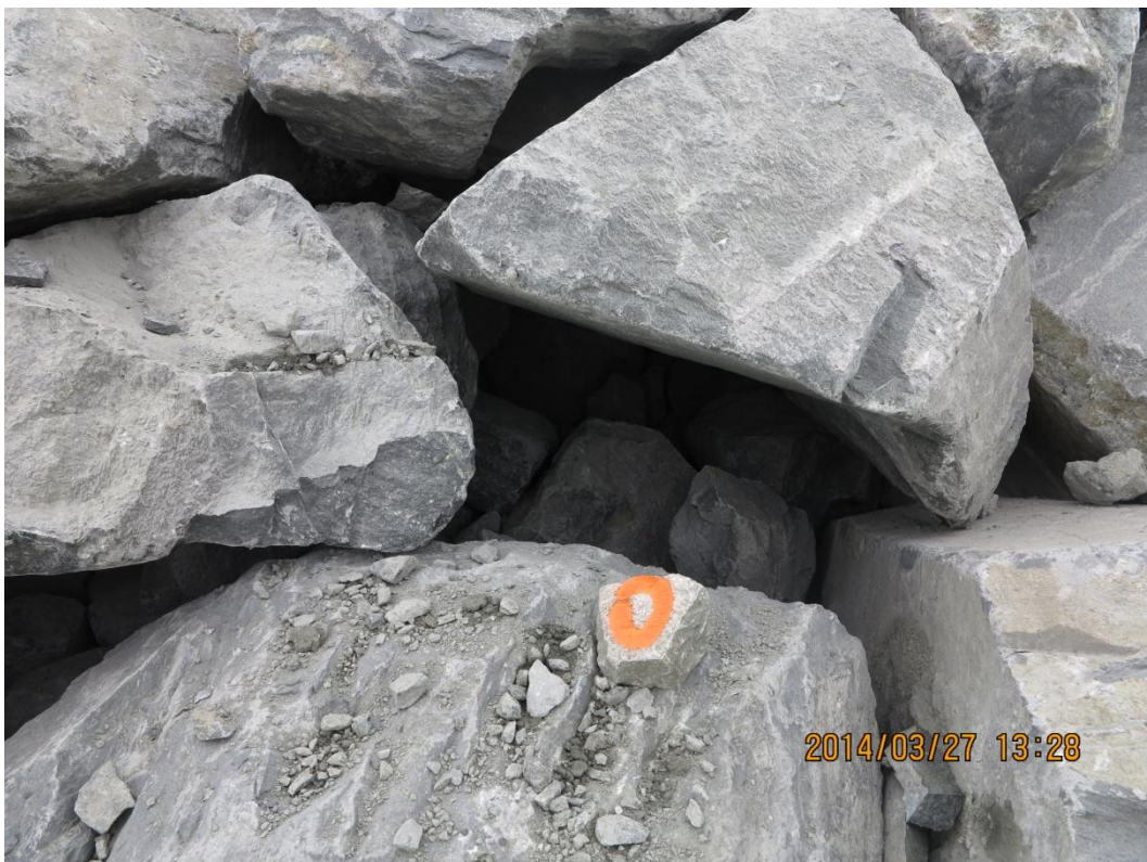
Figur 19: Detaljbilde av plastring der kontrollør har markert at det er for stort hull mellom steinene (foto: Norconsult).
