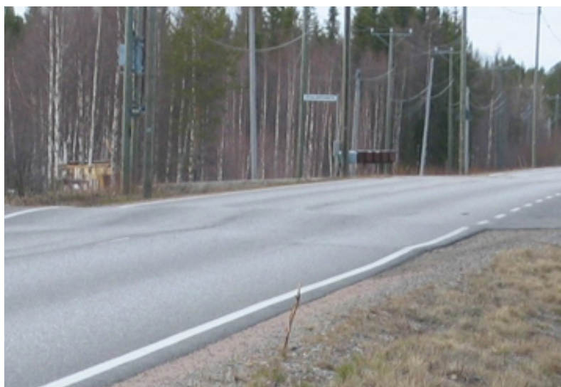
Figur 2-7. Setninger på langs av veibanen (Roadex Network, 2013)
