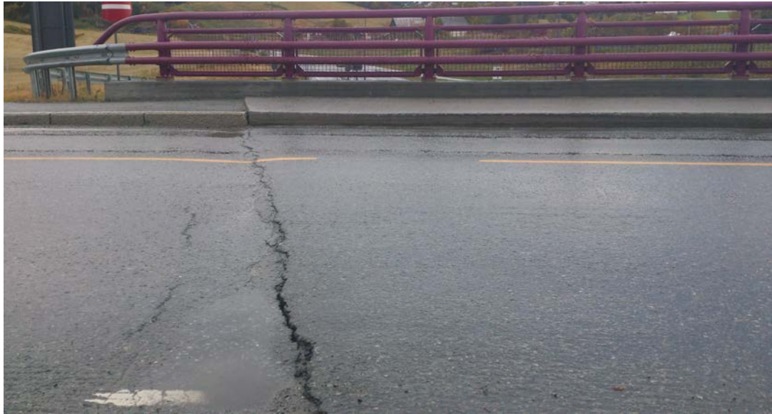
Figur 6-14. Skader brudekket Overgangsbru Børsea (Bratlie, 2013)
