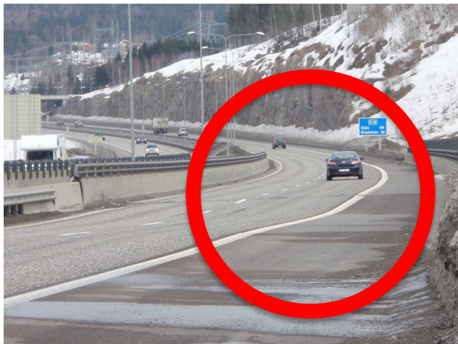
Figur 1-1. Setning inn mot brukonstruksjon, E18 ved Tønsberg (Oset, 2011)
