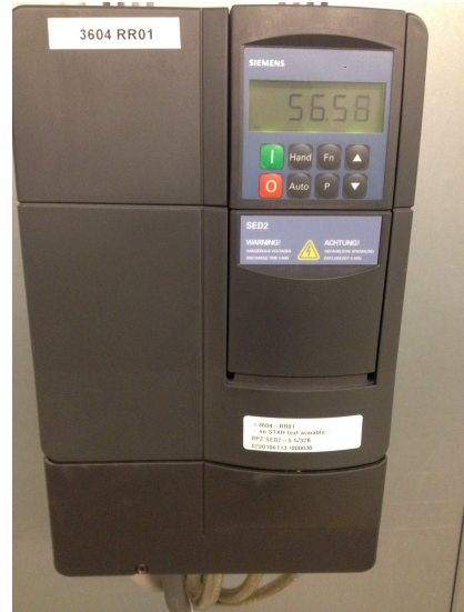
Figur 4.3: Frekvensomformerer installert for tilluftsviften i ventilasjonsanlegget i Rosenborghallen
