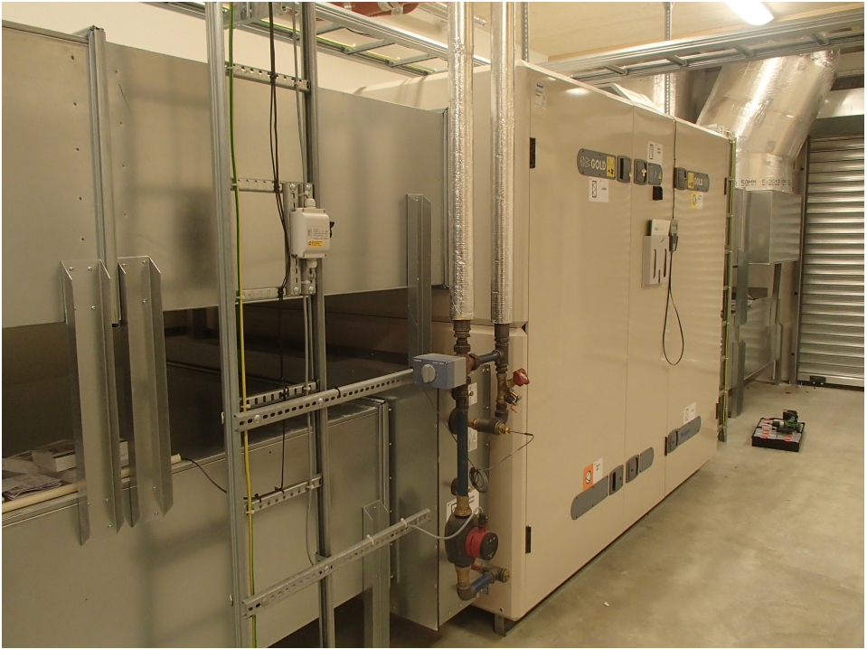
Figur 4.9: Ventilasjonsanlegget i Rollaghallen
