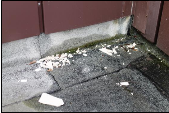
Bilde 17, over: Gipsplatene i veggene til ventilasjonsrommet smuldrer opp. Det er meget fuktig og utette detaljer i hjørnet mellom ventilasjonsrommet og oppbygg for taket over svømmehallen.
