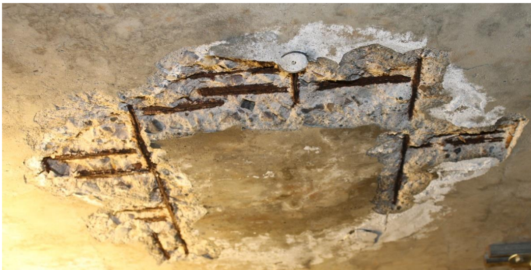
Bilde 14: avskalling og korrosjon under dekket
