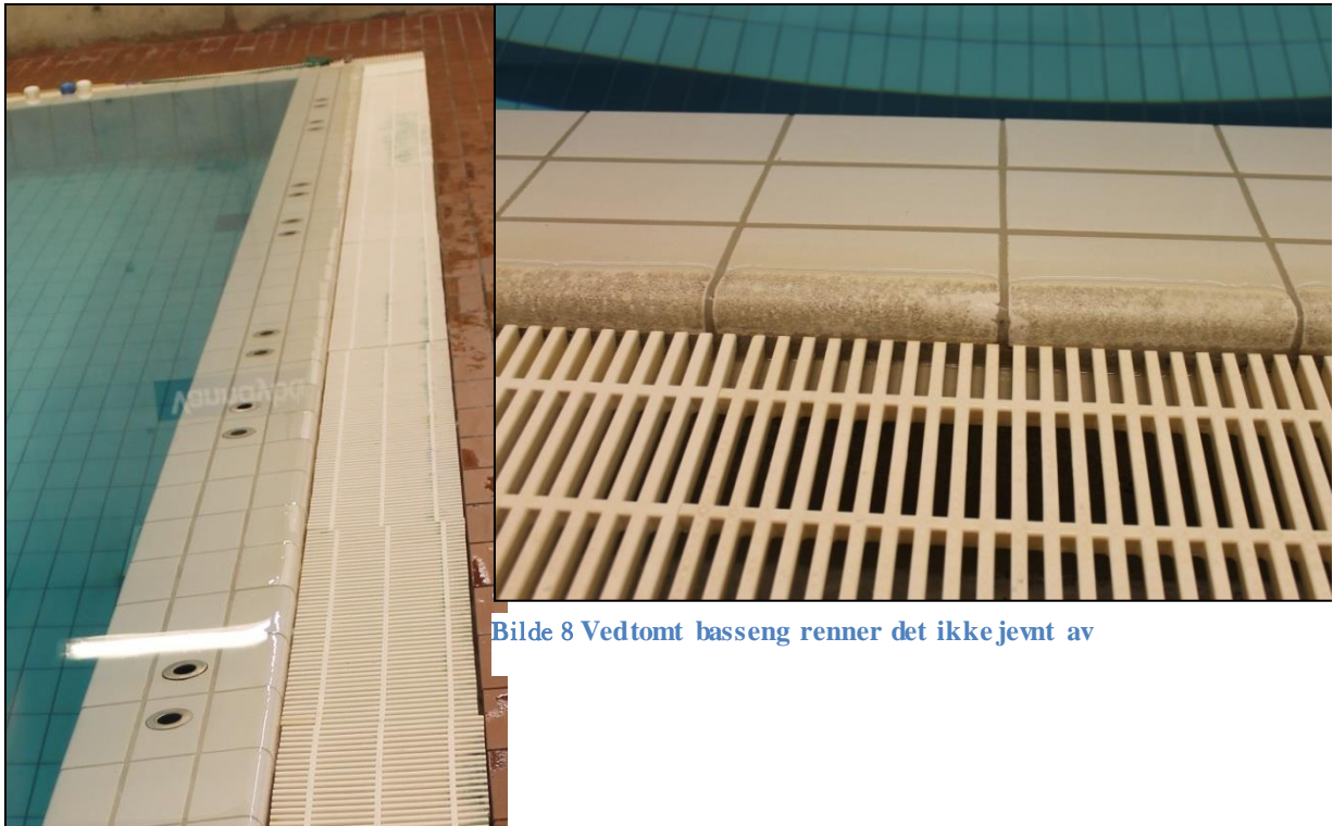
Bilde 7 Flere meter uten avrenning
