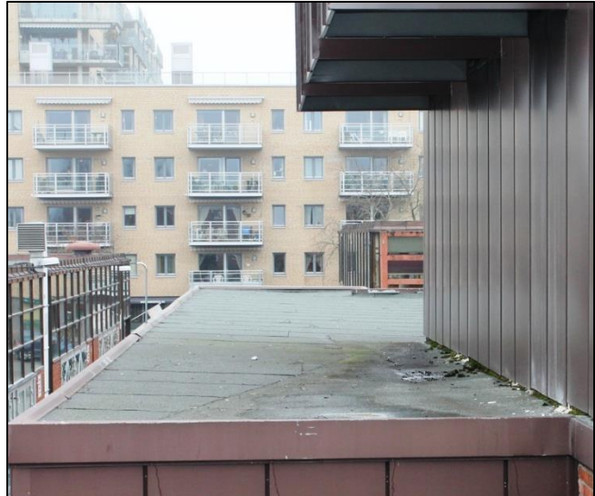
Bilde 19, over: Taket over vestibylen er fuktig og har fall mot veggen til ventilasjonsrommet.
