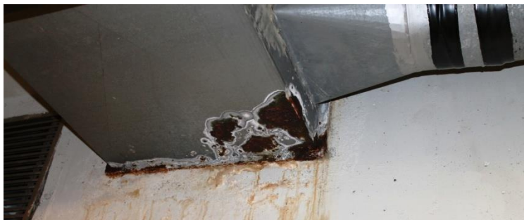
Bilde 19: Korrosjon i luftanlegget
