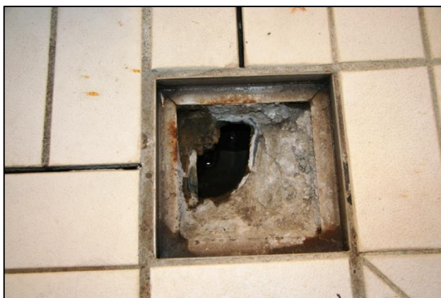
Bilde 4, til høyre: slisene i gulvet er spylerenne. Sluket ser uttett ut.
