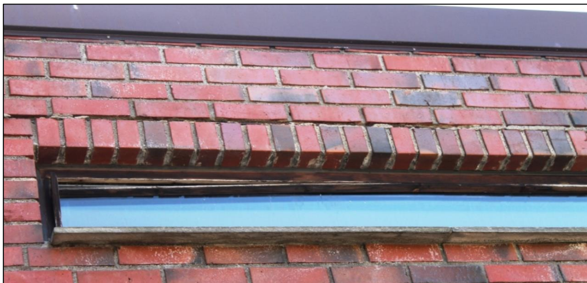
Bilde 18, under: Trekarm rundt vindu sprekker opp og mørtelen over vinduet tøres bort av vann og er delvis borte på grunn av frostsprengning.
