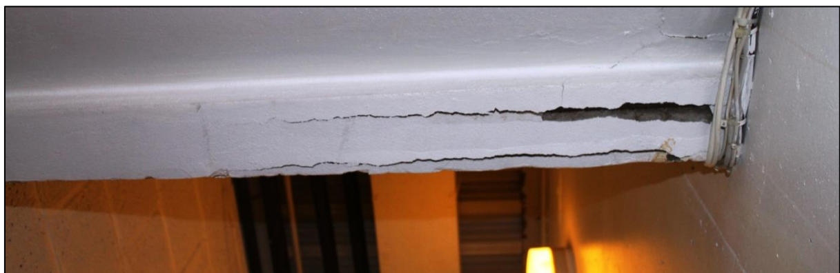
Bilde 27 Betongvegg over trapp sprekker opp fra undersiden på grunn av lekkasje i taket over.
