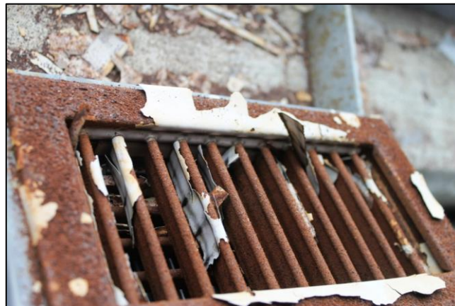
Bilde 35: tilluftsventil har flasket av og er kraftig korrodert
