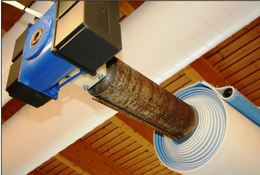
Bilde 16: oppheng for bassengoverdekningen korroderer. Foto: Arne Nesje
