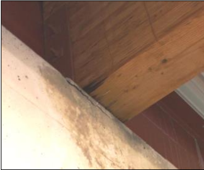
Bilde 22 Fuktspor i enden av limtre drager
