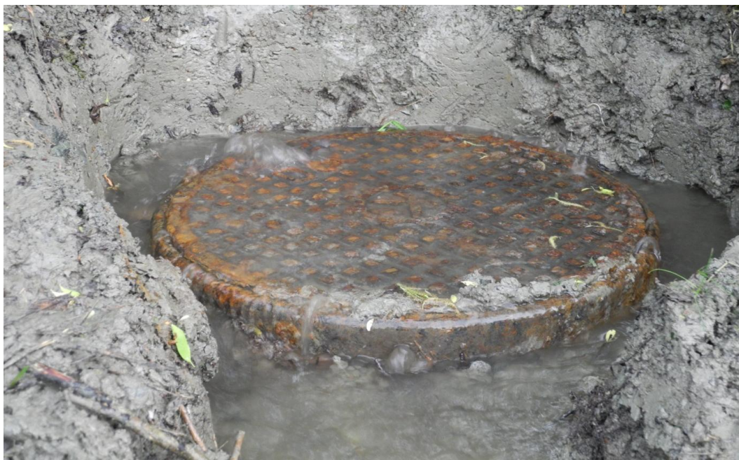
Figur 4.3: Rør går fulle ved enkelte regnskyll på Risvollan.
