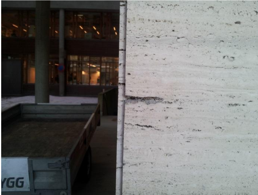
FIGUR 4.2-1 SPREKK I STEIN, MEST SANNSYNLIG EN LIFT SOM HAR KJØRT BORTI. (EKNES, SPREKK I STEIN [FOTO])
