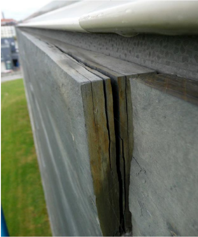
Bilde av delaminering av skifer. Bildet er mottatt av intervjuobjekt på epost.
