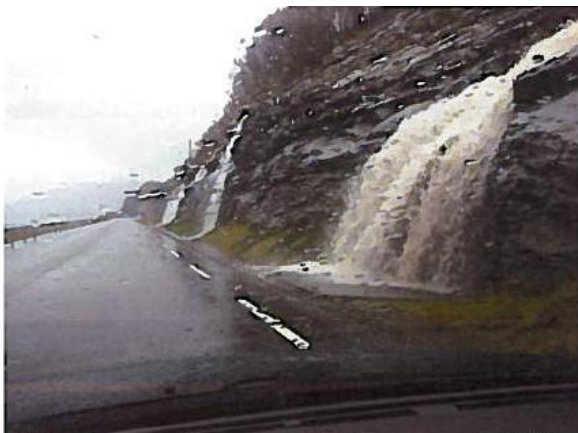
Figur 42 Grunn sidegrøft, etter rekkverksnormalens krav, som har for liten kapasitet. Kilde: Norem, 2012.
