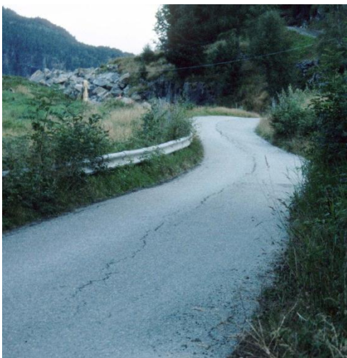
Figur 43 Høyvokst vegetasjon rundt rekkverk. Foto: Harald Sel.
