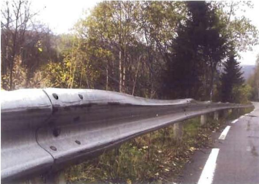
Figur 32 Brøyteskadet stålskinnerekkverk. Kilde: Statens vegvesen, 2002b.
