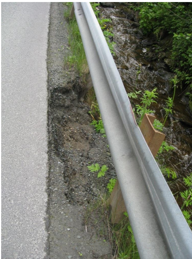
Figur 16 Rekkverk nær skråningstopp. Foto: Øystein Larsen, Statens vegvesen.
