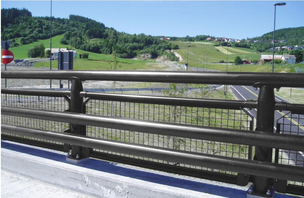
Figur 31 Brøytetett rekkverk. Kilde: www.vikorsta.no .
