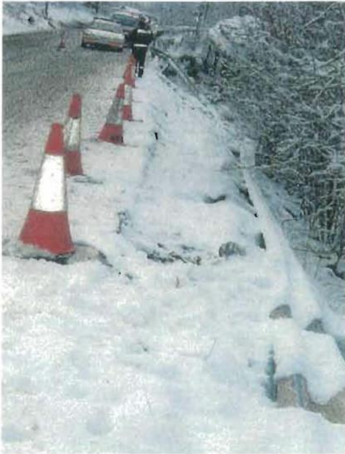
Figur 18 Overkjørt rekkverk. Kilde: Statens vegvesen, 2002b.
