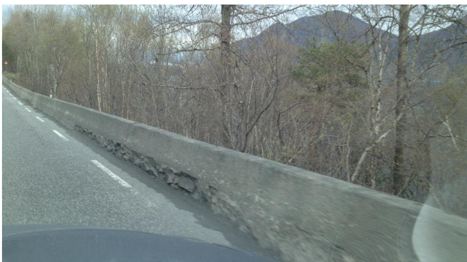
Figur 35 Brøyteskadet betongrekkverk. Foto: Alex Klein-Paste.
