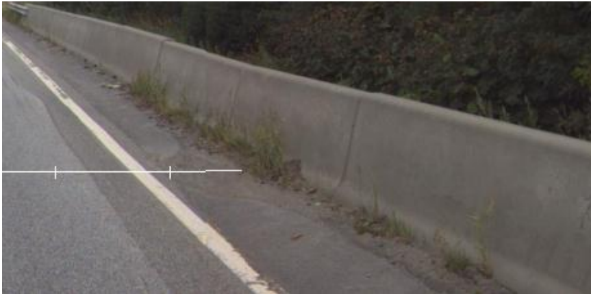
Figur 20 Betongrekkverk med igjengrodde dreneringshull. Foto: ViaPPS.
