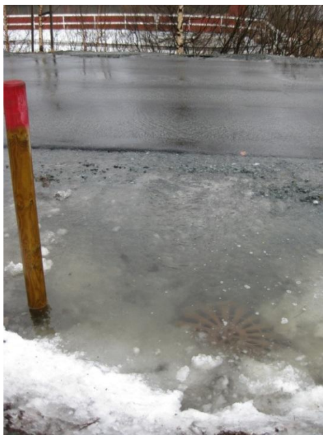
Figur 26 Svært dårlig drenering ved start snøsmelting februar 2012, ved måleplas 2.
