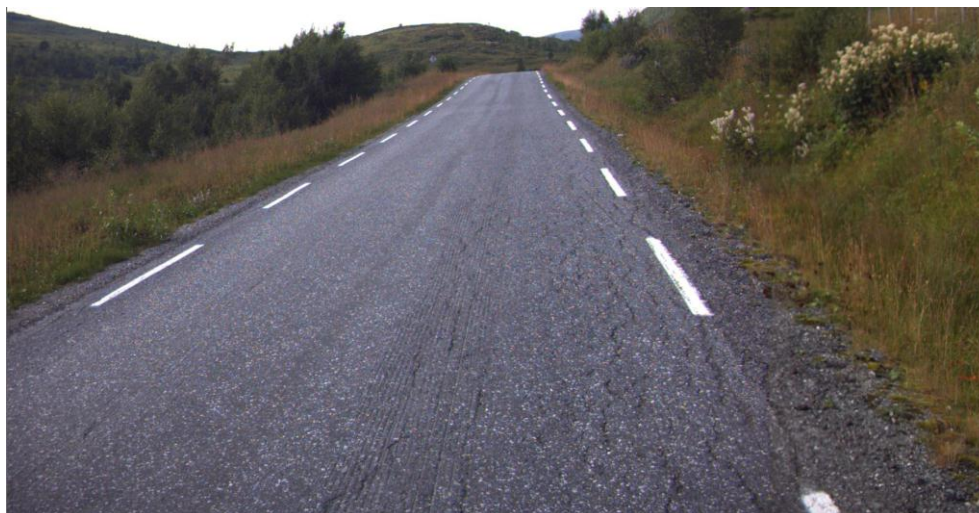
Bilde 24 Eksempel på sprekker som brer seg fra skulderen og innover. Profil 1610 (NVDB, 2012)
