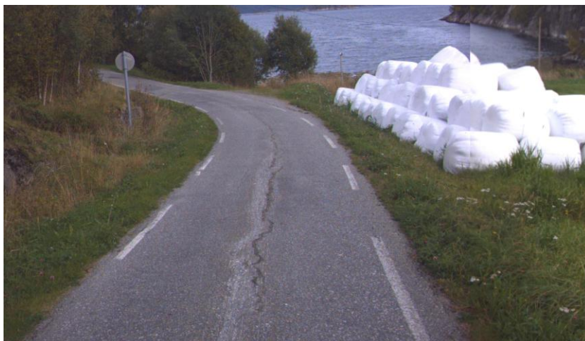
Bilde 18 Eksempel på sprekk midt i vegen. Strekningen med karakter H, Profil 1333. (NVDB, 2012)
