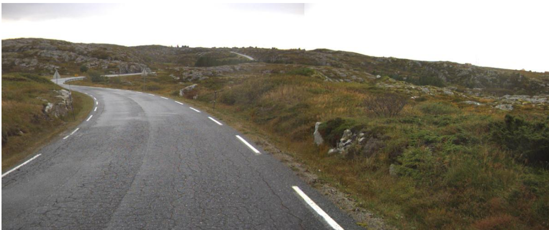
Bilde 42 Eksempel på krakelering av hele vegbanen. Profil 5195. (NVDB, 2012)
