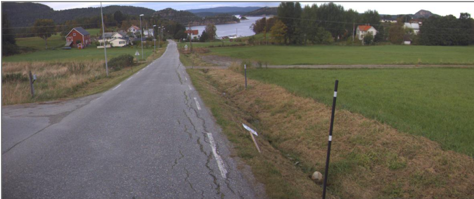
Bilde 33 Eksempel på sprekker i ytre hjulspor/ ved skulderen. Profil 1500. (NVDB, 2012)
