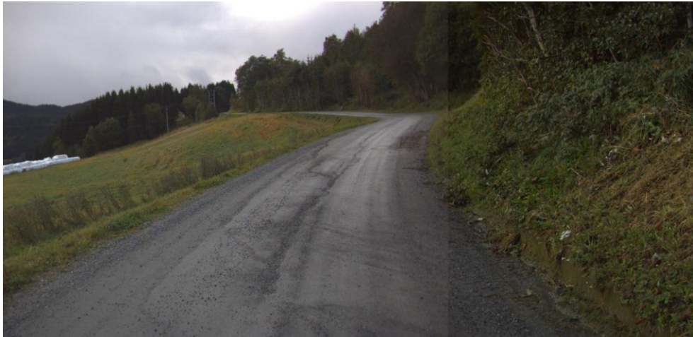
Bilde 60 Eksempel på langsgående «sprekker» midt i vegbanen. Profil 412. (NVDB, 2012)
