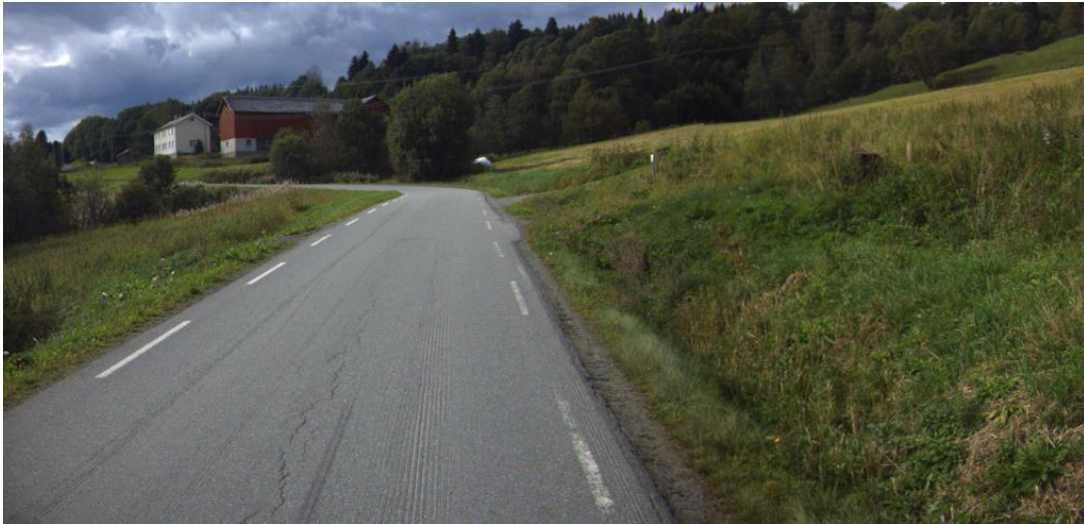
Bilde 51 Eksempel på langsgående sprekk midt i vegbanen. Profil 7493. (NVDB, 2012)
