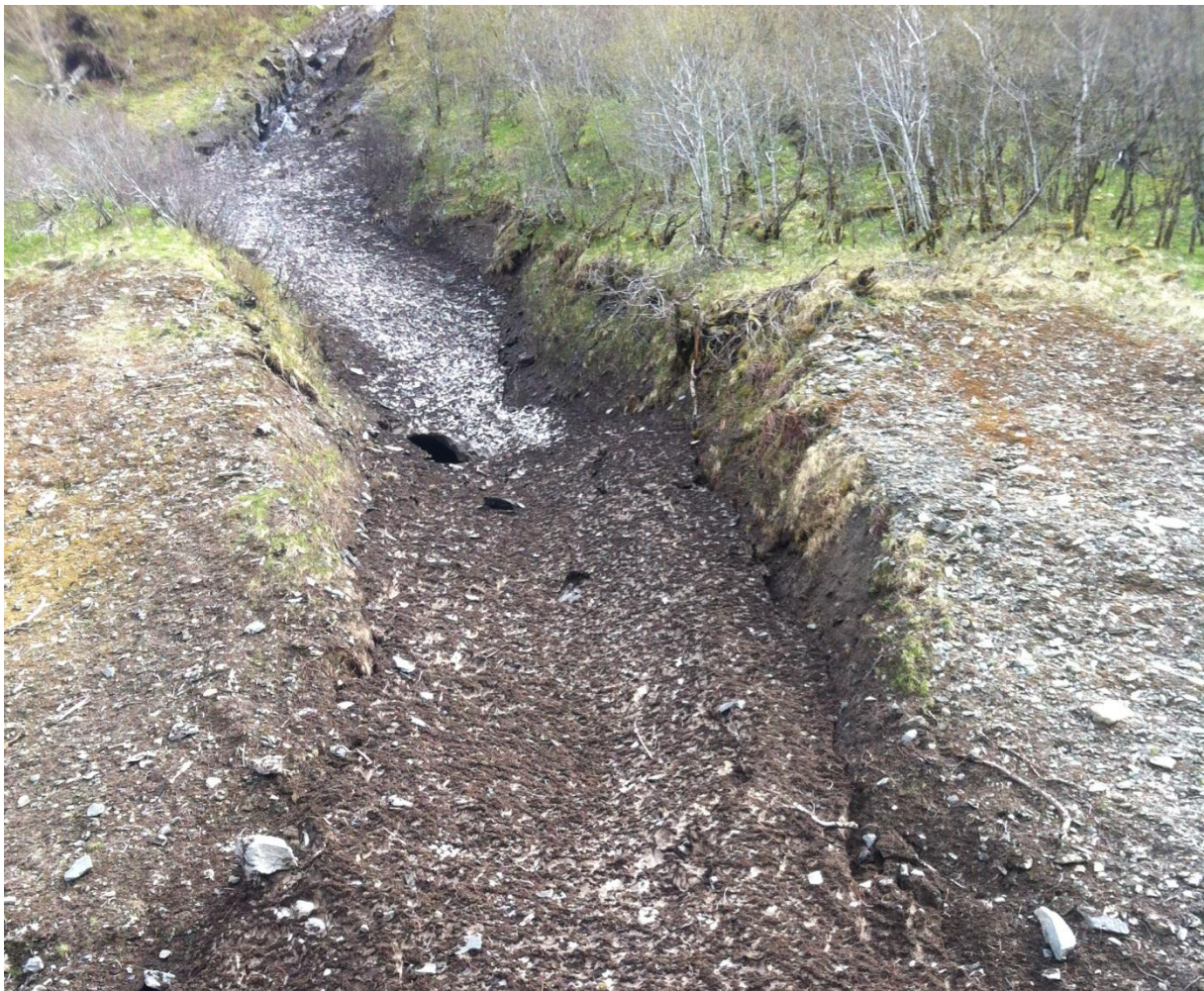
Figur 6-80 Blomasvora – Hovedskredløpet har erodert i bekkeløpet
