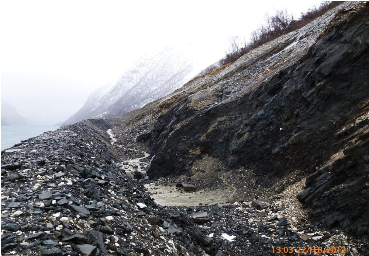
Figur 6-71 Seljesvora/Jonsoksvora – erosjon og vannansamlinger ved midten av tiltaket
