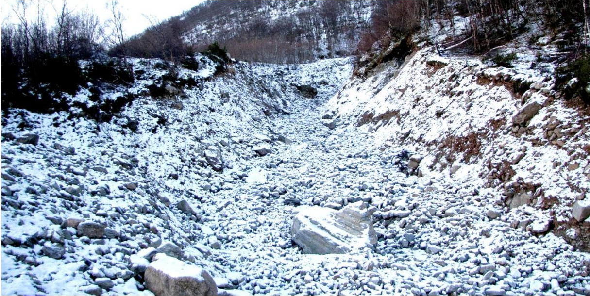
Figur 6-36 Seljesvora - erodert skredløp
