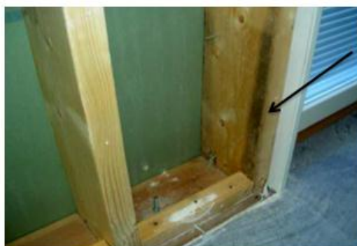
Figur 15 Eksempel på en ferdig montert stender som er angrepet av muggvekst. Kilde: (Land & Must, 2004).
