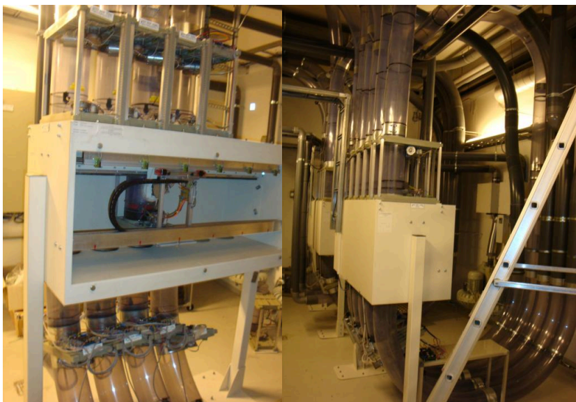
Figur 19 Fra veksler i ”veikryss” for rørpostsystemet ved St.Olav i Trondheim (foto: forfatteren, mars 2009)
