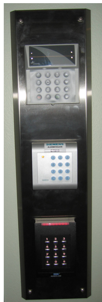
Figur 5.5 Adgangssystem ved Øya helsehus
