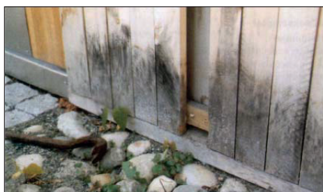
Fig. 6.17. Panelkledd yttervegg på krematoriet på Moholt i Trondheim. Et eksempel på råte i endeved. Foto: SINTEF Byggforsk.
