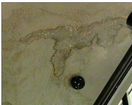
Fig 7.4.13. Merker etter lekkasjer i taket over seremonirommet.
