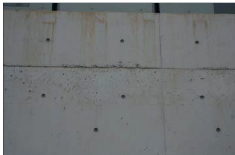
Fig. 6.15. Yttervegg i et nytt offentlig bygg av eksponert betong. Fremtredende er tilsmussing fra vinduer, feilplassert staghull og stygge avtrykk etter forskalingen.
