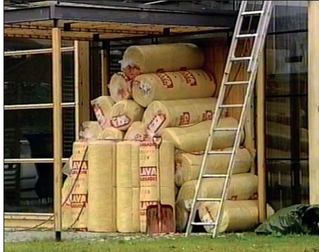
Fig 7.4.15. Byggematerialer som skal brukes til utbedring av taket over seremonirommet. Kilde: TV- Trøndelag (2000).
