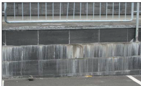
Fig. 6.16. Fliskledd yttervegg på nybygg i Reykjavik. Fukt fra terrassen kommer seg bak flisene.
