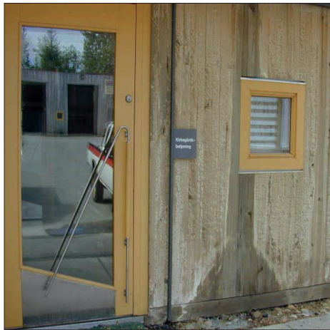
Fig. 7.4.25. Fasade mot øst der man ser innsetting av vinduer og dører, men også skadede trepanel. Fotoet er fra juli 2002, etter at byggskadene i fasaden ble utbedret.
