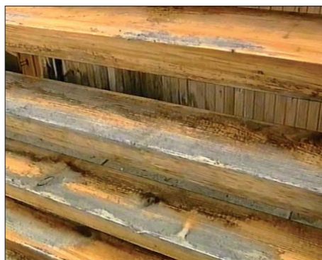
Fig 7.4.14. Utvendig treverk med merker etter klimapåkjenning.
