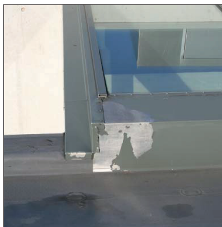
Fig 7.5.34. Foto fra taket. Detalj der glasstaket møter tett tak. Påkjenninger viser seg på utsatte hjørner.
