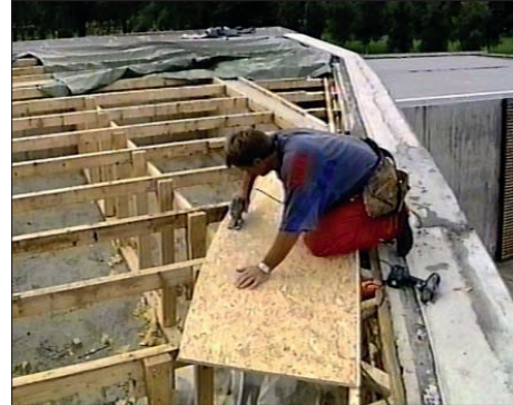
Fig 7.4.16. Arbeid med utbedring av trevirket i taket over seremonirommet. Kilde: TV- Trøndelag (2000).
