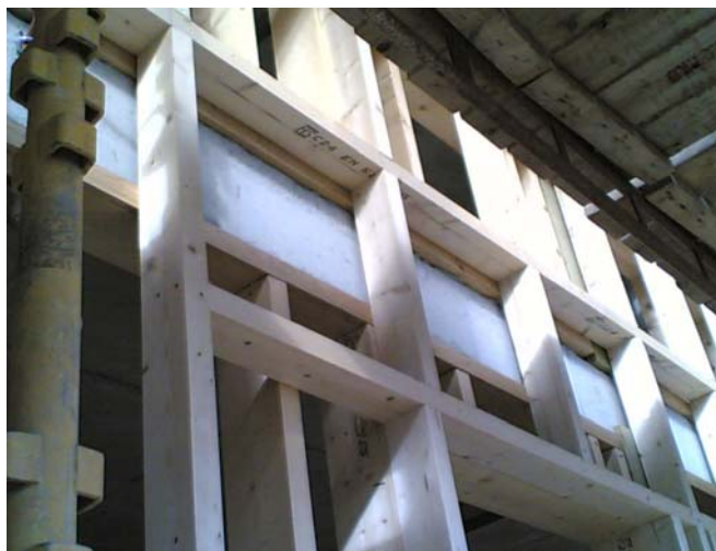
Figur 6-4 Todelt stenderverk i yttervegg ved Husby Amfi i Stjørdal. På bildet vises dekkeforkant for etasjeskiller, samt omramming rundt vindu i nedre høyre hjørne. Innvendig stenderverk er plassert på innsiden av dekkeforkant (over og under dekket), mens det ytterste stenderverket er plassert på utsiden.
