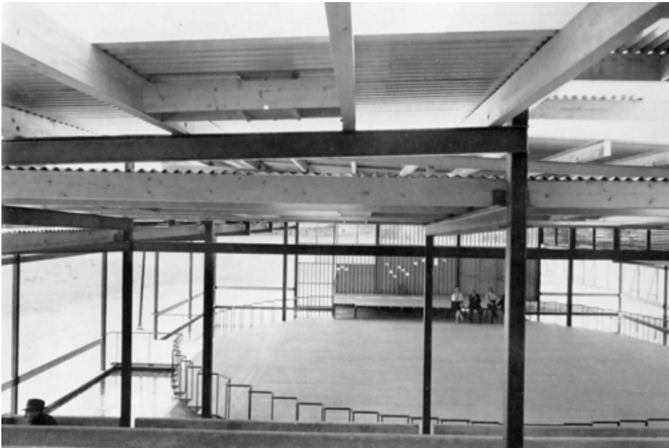
Fig. 65. Are Vesterlid og Hans Østerhaug; restaurant og dansepaviljong på Glomdalsmuseet. Tak over danseplattig. Bildet viser tydelig hvordan aluminiumsplatene ligger rett mot konstruksjonene, og det er ikke gjort noe forsøk på å bearbeide overgangene. Takplatene bygger seg opp over hverandre, og følger bevegelsene på gulvplanet.
