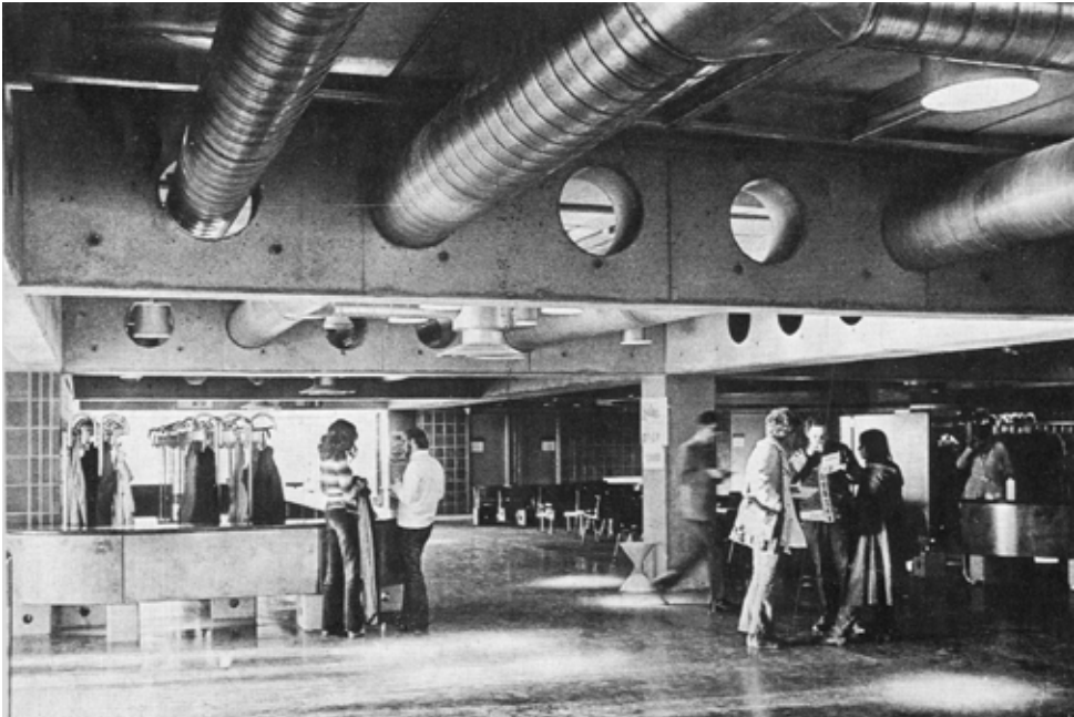
Fig. 36. Kjell Lund og Nils Slaatto; Chateau Neuf. Bildet viser interiøret i vestibylen, med de kraftige ventilasjonsrørene som er godt synlig i himlingen. "Det er poesien i de tekniske anleggs realisme vi har forsøkt å gjendikte i Studentersamfundets nye bygning", skrev Kjell Lund i Byggekunst nr.6/1971
