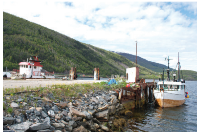
Kaien består av delvis fyllmasse, delvis betongdekke på søyler. Her holder fyllmassen på å rase ut.
