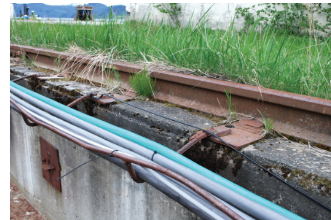
Kransvillene fra tårnkranen ute ligger fremdeles selv om kranen som brukte dem er tatt vekk.
