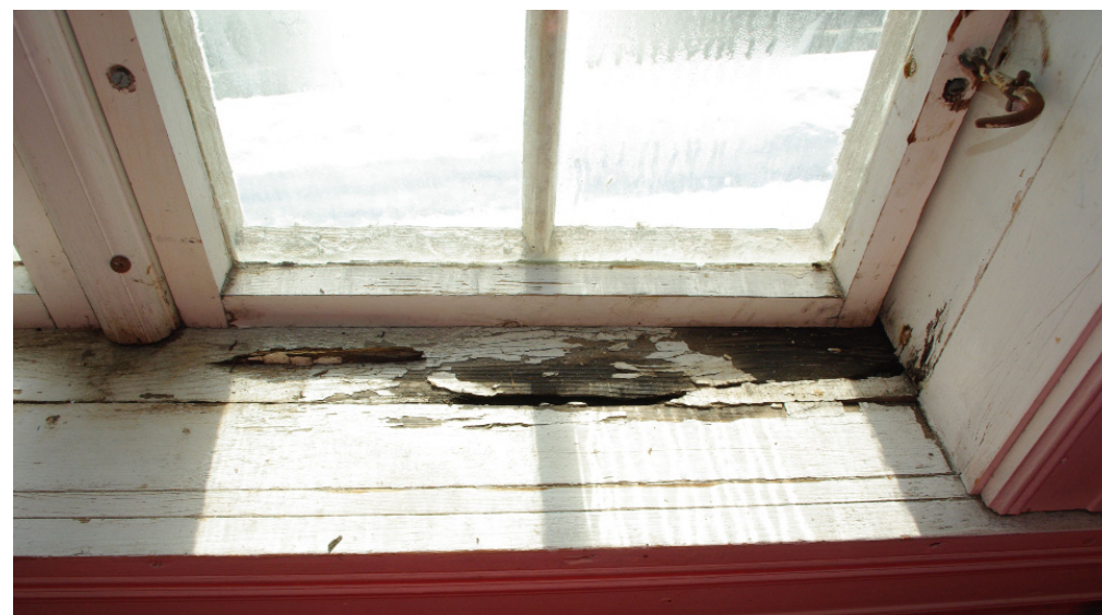
Råteskader i vinduskarmen i soverom 1, B2c
