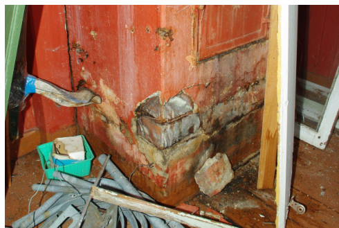
Fuktskader i pipe og gulv i skolegang S1a
