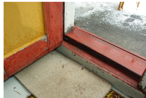
Vasstrukken terskel ved hovedinngangsdør
