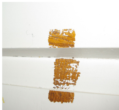
Ådring under hvitmaling på dør
