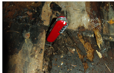
Råteskadet trevirke i loftsgulv
