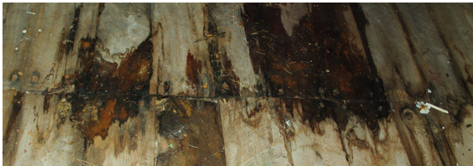
Det vises at en vannlekkasje har fått fritt spillerom i mange år på loftsgulvet
