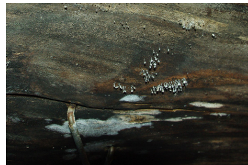
Fuktskader og soppvekst i troet rundt vindu
