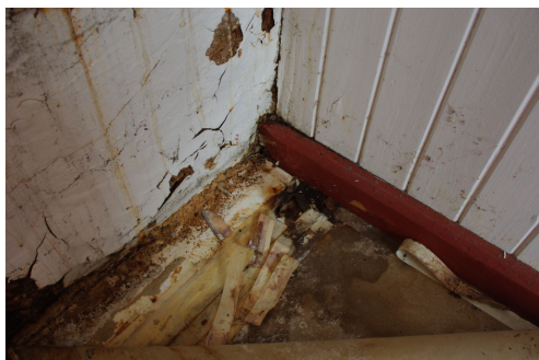
Fuktskader ved pipe i stue 2, B1c
