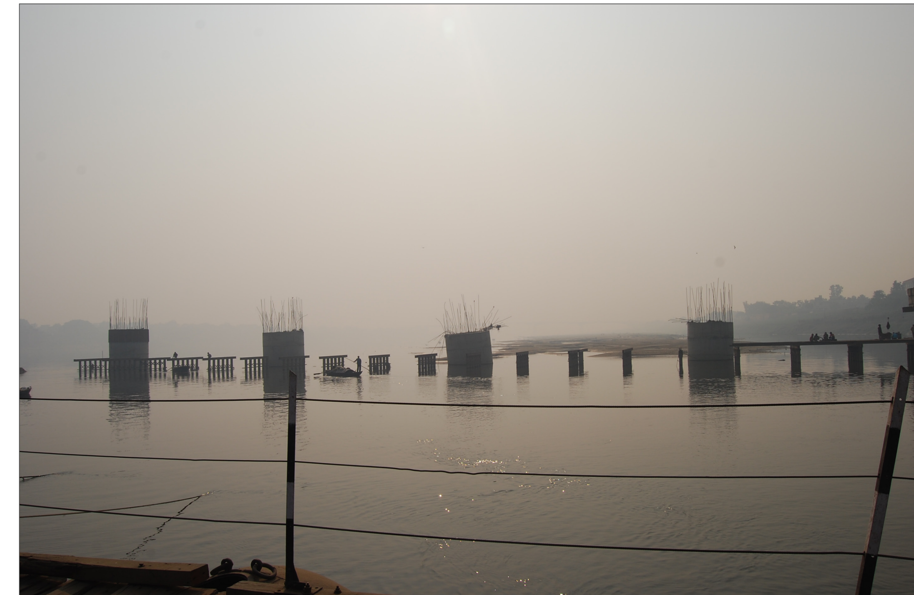
bro under konstruksjon, Varanasi, India. Den første delen av broen er allerede tatt i bruk
