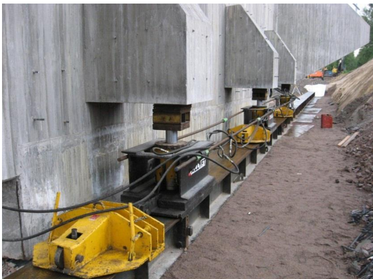
Figur 20: Hydrauliske jekker brukt i Sverige, kilde: Statens vegvesen, foto Morten Wangen
