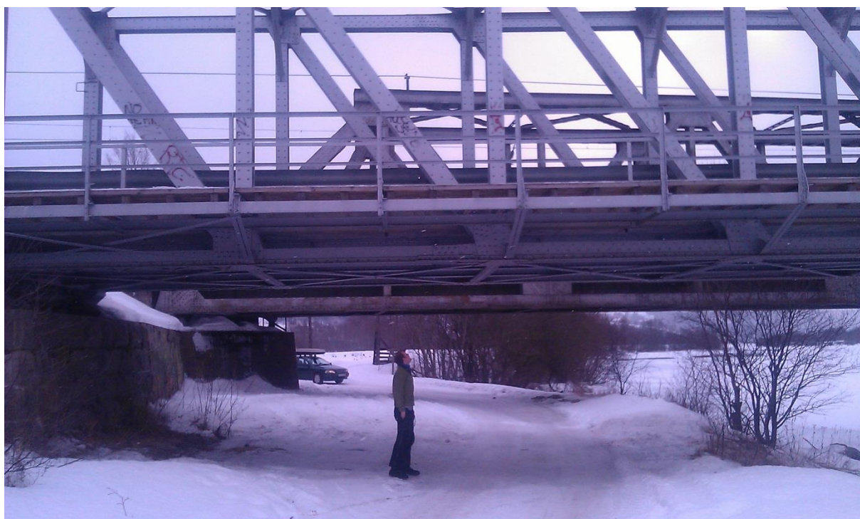
Figur 54: Lav passasje under jernbane og vegbru over Lågen i vest, Foto: Gard Stadheim
