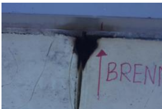
Sprekk i isolasjon (100 min)
