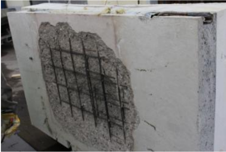
Figur 29 Avskalling Betong G430, Illustrasjon Eikeset
