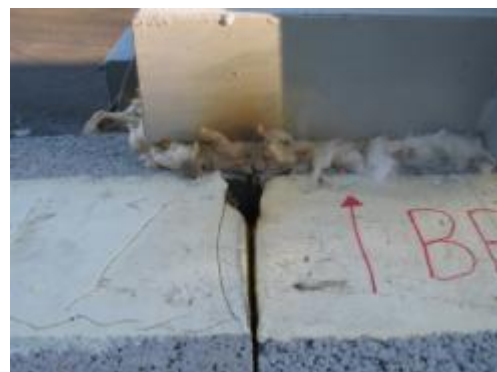
Sprekk i isolasjon (119 min)
