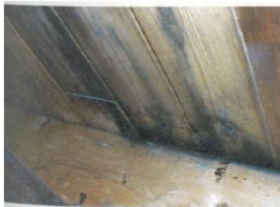
Bilde 5: Cladosporium på vegg
