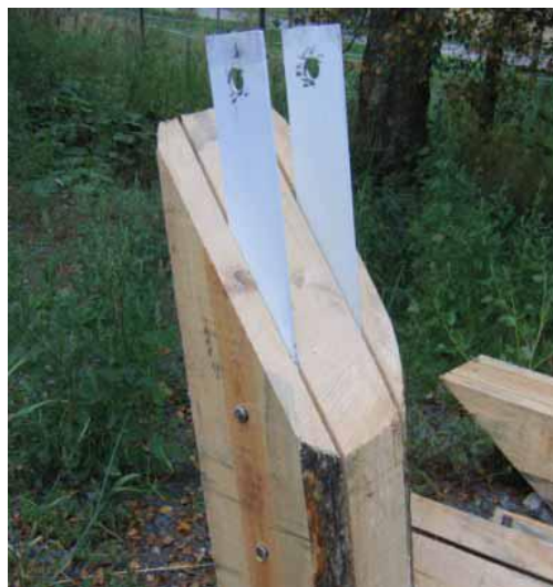
Figur 10 Detalj, innslissede stålplater Foto: Landbygg AS
